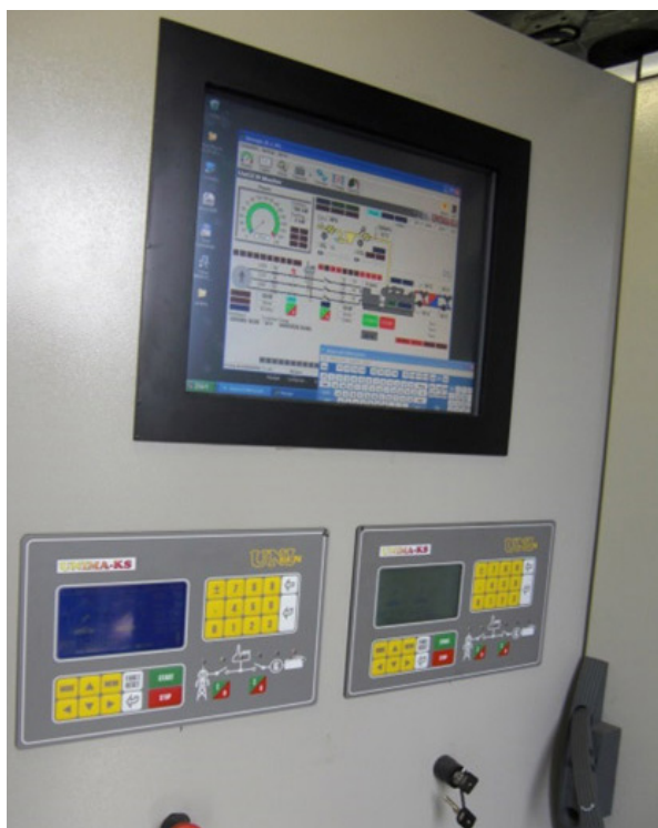
Control panel in Gyál.
